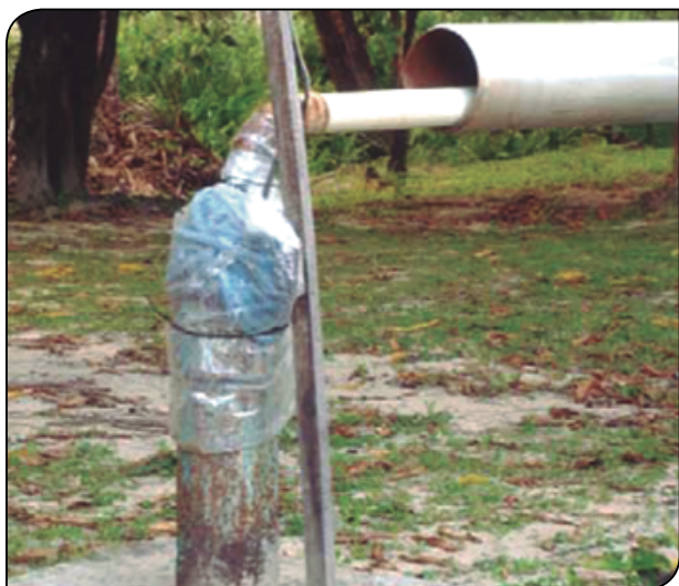
Figura 3. Condições da tubulação que leva o cloro à água tratada (Unidade Operacional 7 de Setembro). Fonte: CRUZ, 2012.
