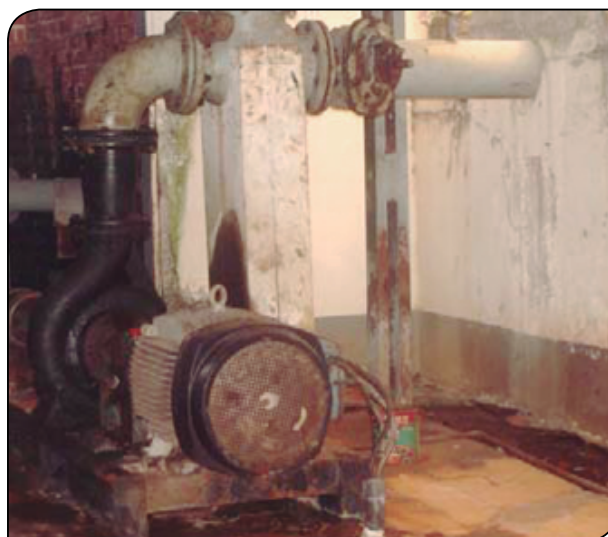
Figura 5. Conjunto motor-bomba da Unidade Operacional 7 de Setembro. Fonte: CRUZ, 2012.
