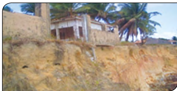
Figura 10. Erosão de ruas e casas (Braga, 2007).
