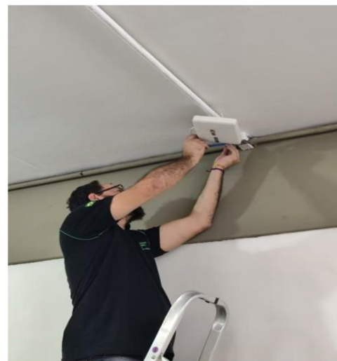
Figura 28 - Instalação de AP's
